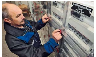
Wilfried Genow am Schaltschrank für die Notbeleuchtung
