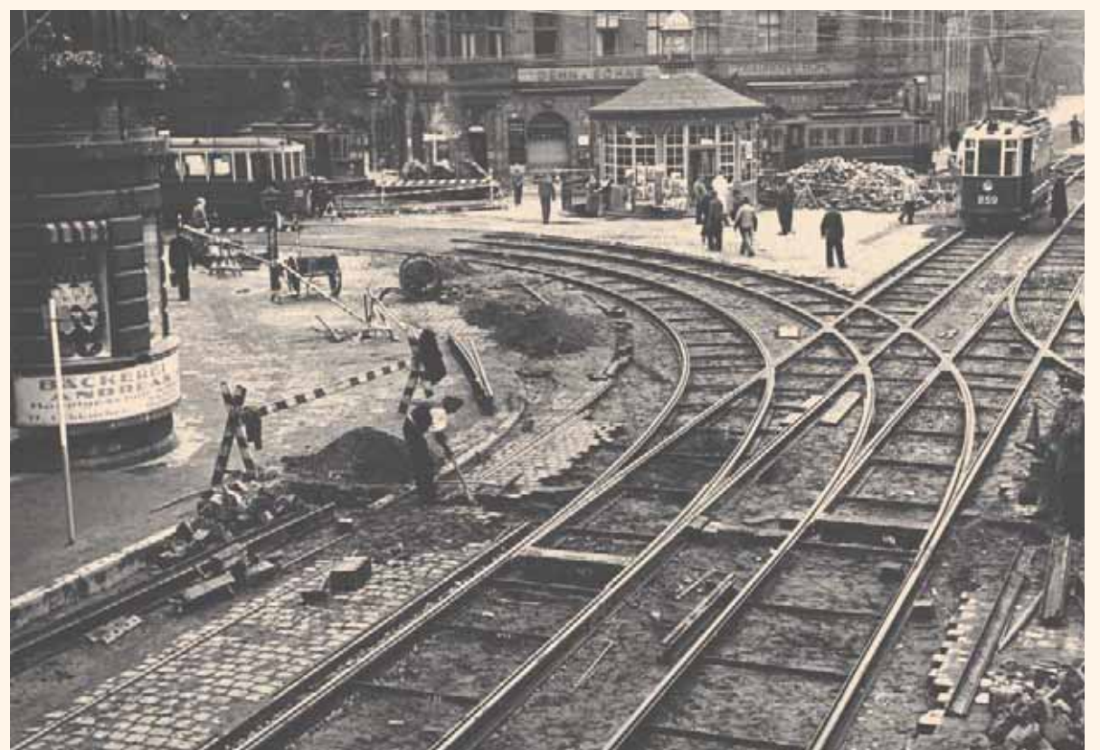
Bauarbeiten im Rahmen der Verbreiterung des Altstadtrings (Maxfeld an der Kreuzung Äußere Bayreuther – Pirckheimer Straße). Im Hintergrund Straßenbahnzüge der Linien 5 und 15.
