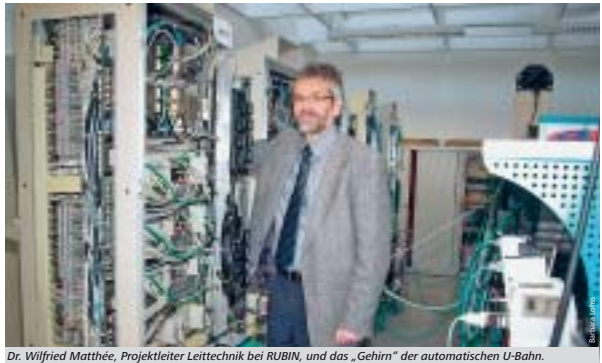
Dr. Wilfried Matthée, Projektleiter Leittechnik bei RUBIN, und das „Gehirn“ der automatischen U-Bahn.
