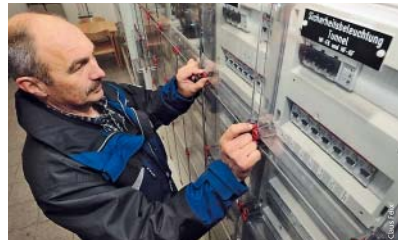
Wilfried Genow am Schaltschrank für die Notbeleuchtung
