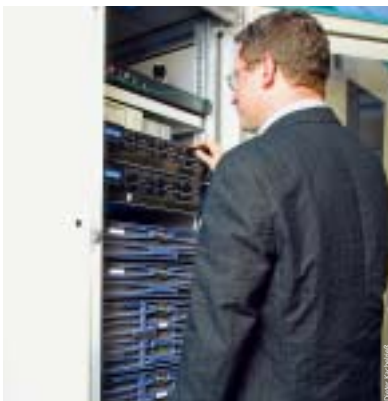
Matthias Striebich, Leiter Instandhaltung Zugsicherung, am neuen Server
