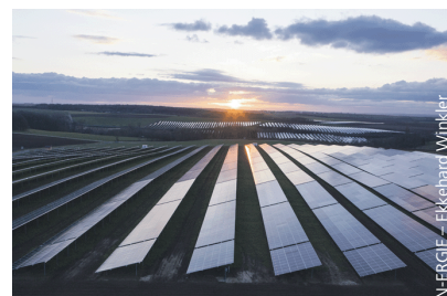
N-ERGIE PV-Anlage in Wässerndorf
